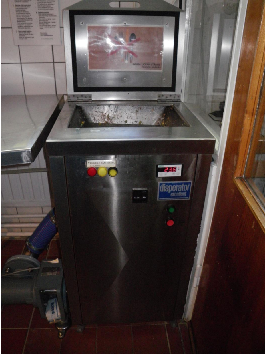
Figur 1. Matavfallskvarn installerad i köket på Johan Skytteskolan. Foto: Ulf Nordberg
